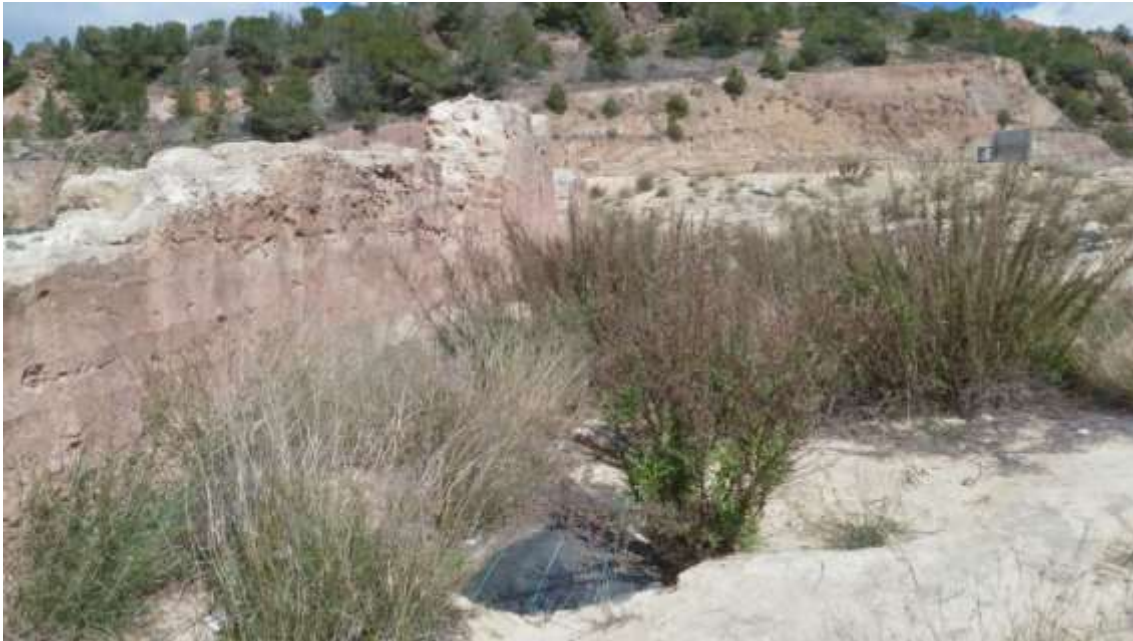
Vista de los muros totalmente abandonados, donde la maleza está rompiendo el geotextil de la reconstrucción.
