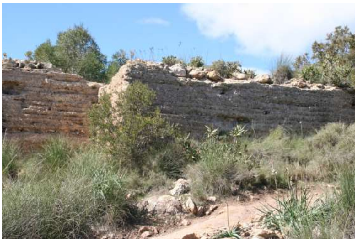
Las raíces de la vegetación existente deterioran los muros del castillo del S. XII.
